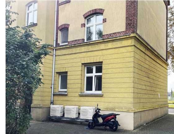
Außeneinheiten der Splitgeräte
