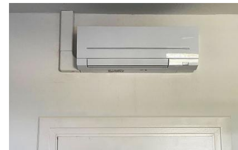
Inneneinheiten der Splitgeräte
