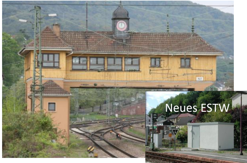
Stellwerk Neustadt. Denkmalschutz, Dachsanierung wegen einzelner Ziegelabgänge
