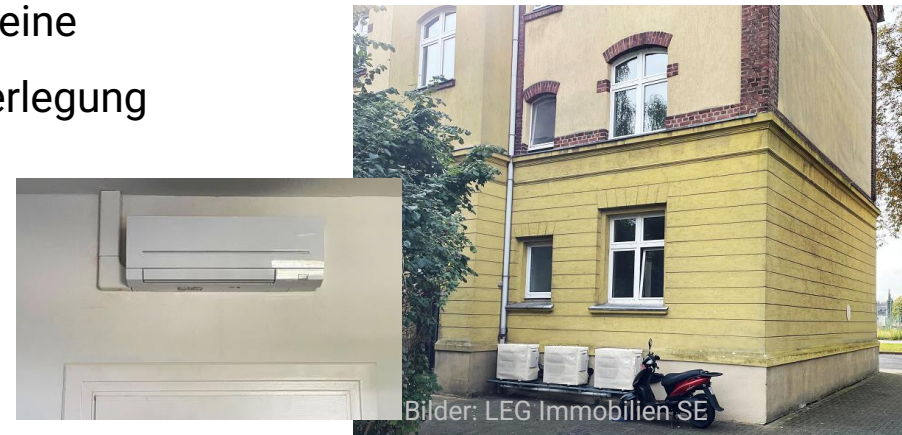
Inneneinheiten und Außeneinheiten der Splitgeräte
